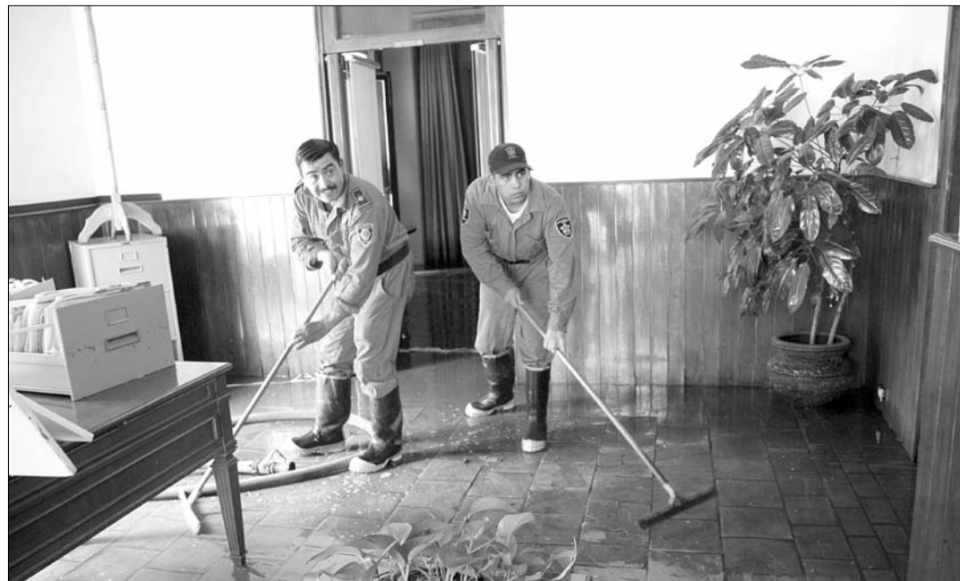
Personal del cuerpo de Bomberos realizó actividades de limpieza en oficinas públicas, luego de que una fuerte lluvia provocó inundaciones en el centro de la ciudad capital la tarde-noche del pasado miércoles
