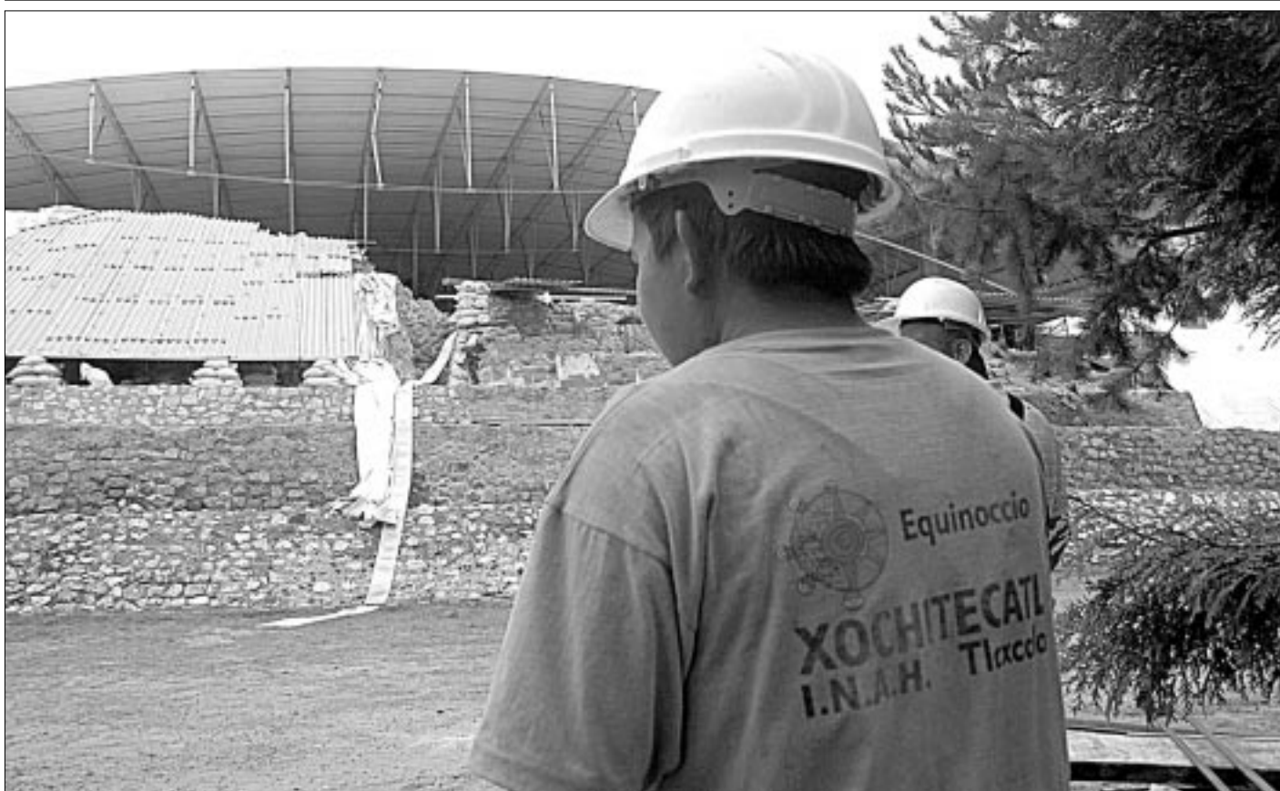
Entre 6 y 8 meses la zona arqueológica de Cacaxtla permanecerá parcialmente cerrada al público, mientras se realizan diversos trabajos para mejorar los accesos y reparar la techumbre ■ Foto: Alejandro Ancona
